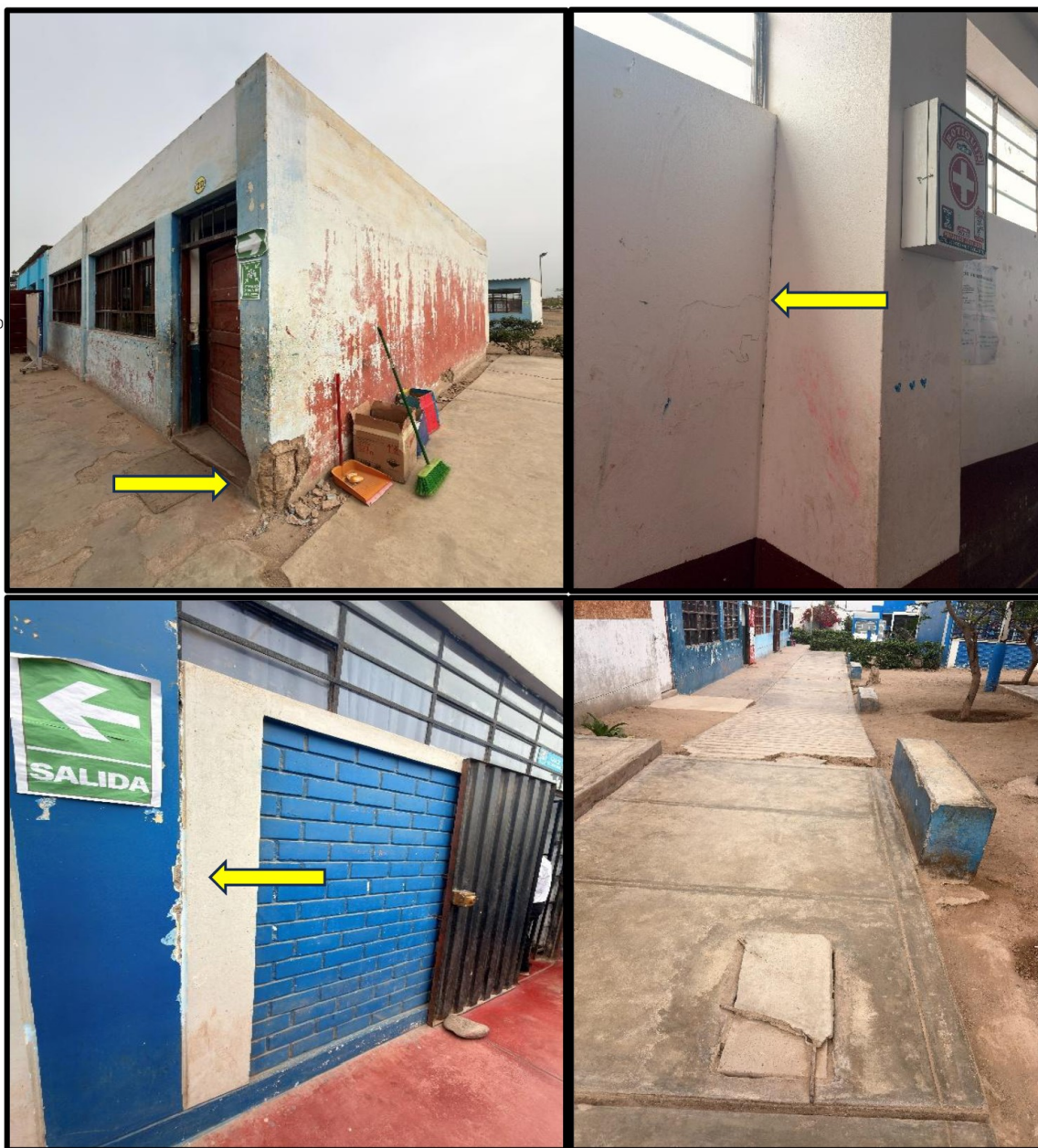
Imágenes 8, 9, 10, 11 y 12 Ambientes con deficiencia en la infraestructura
