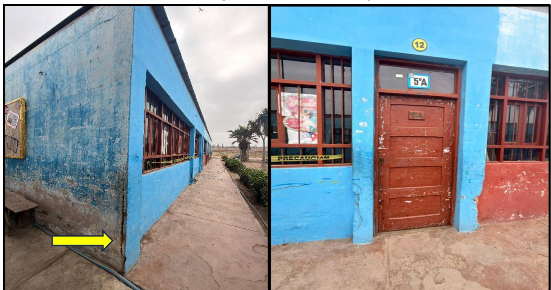
Imágenes 1, 2, 3, 4 y 5 Estructuras declaradas de alto riesgo sin la correcta señalización para limitar tránsito
