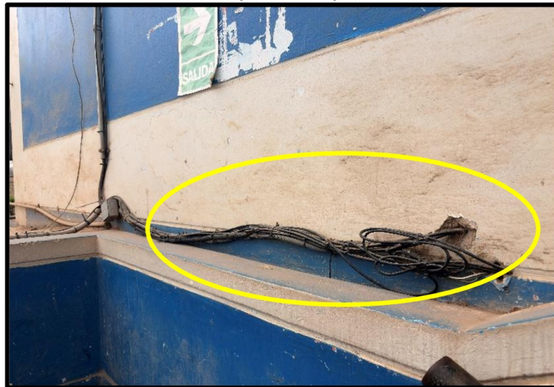
Imagen 15 Conexiones eléctricas expuestas en el pabellón de nivel secundaria
